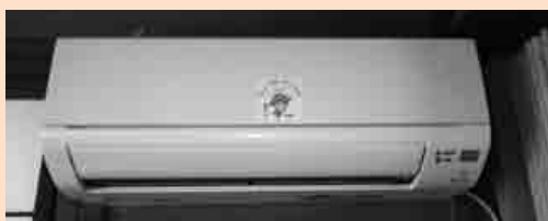
助成金で整備されたエアコン
