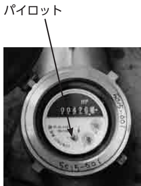
水道メーター
