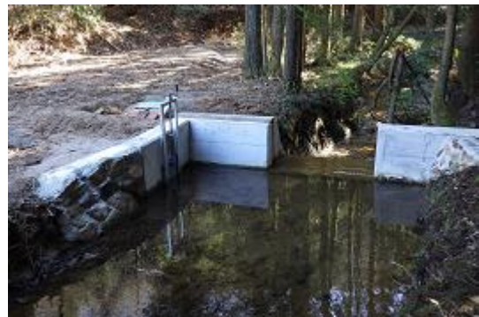
事業により整備した取水施設
