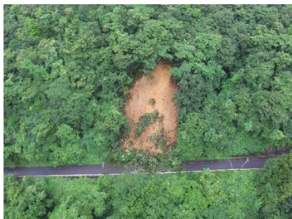
町道法面崩壊 復旧前
