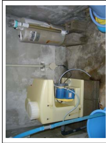
塩素滅菌設備
