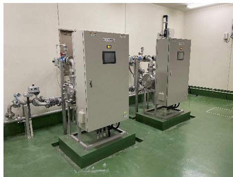
『浄水場内にある紫外線処理装置』
