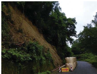
町道法面崩壊 復旧前
