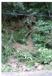
町道法面崩壊 復旧前
