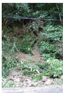
町道法面崩壊 復旧前
